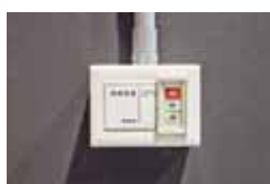
施設の排煙装置を 一部電動化
