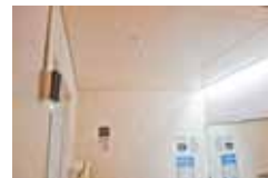
各階トイレの照明を 人感センサーを設置し 自動点灯化
